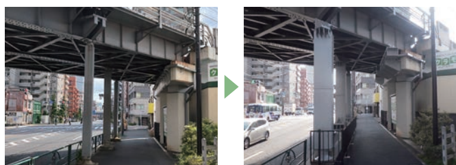
ロッキング橋脚：大井町線旗の台～北千束間（中原架道橋）耐震工事前と工事後
