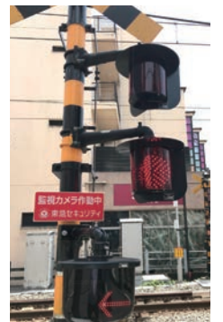
一部の踏切道に導入している全方位警報灯
